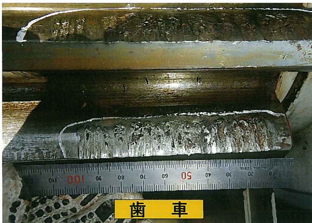
スポーリングが発生したギヤ表面
